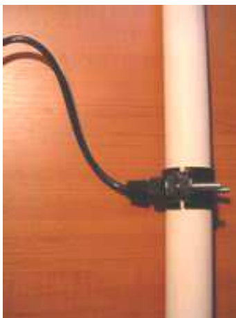
Richtig: Spülwasser der Osmose läuft von oben in den Siphon
