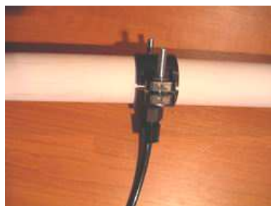
Falsch: Spülwasser der Osmose läuft von unten in den Siphon.
